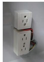
内部コンセント (3P 3 コ口)
